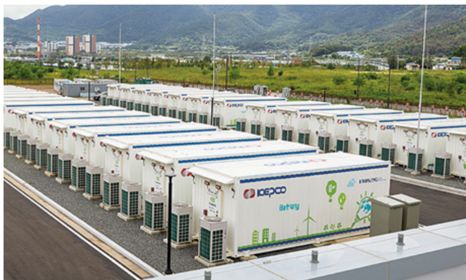
Un sistema de almacenamiento de energía (SAE) en baterías de 978 MW de Korea Electric Power Corp. en Corea del Sur. (Imagen: KEPCO)
