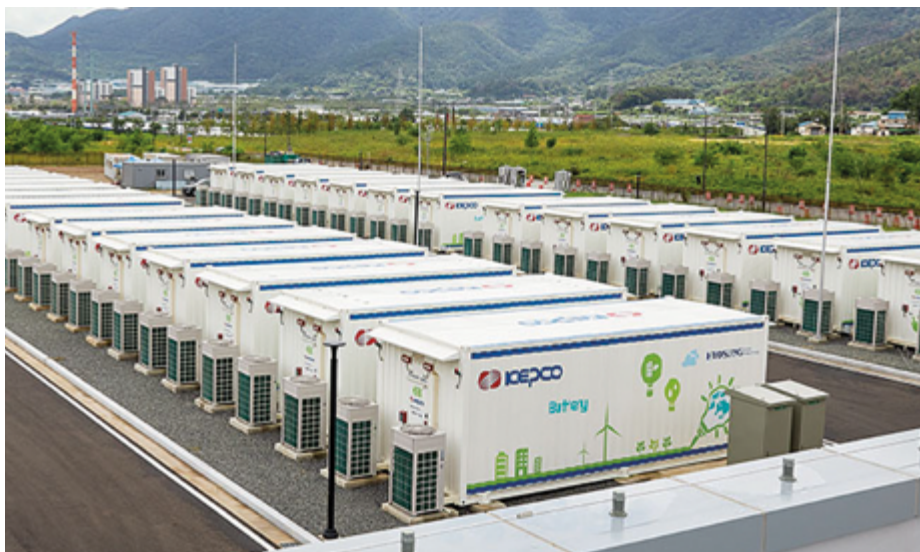
韩国电力公司在韩国的978兆瓦电池储能系统。 (图片来源:韩国电力公司KEPCO)
