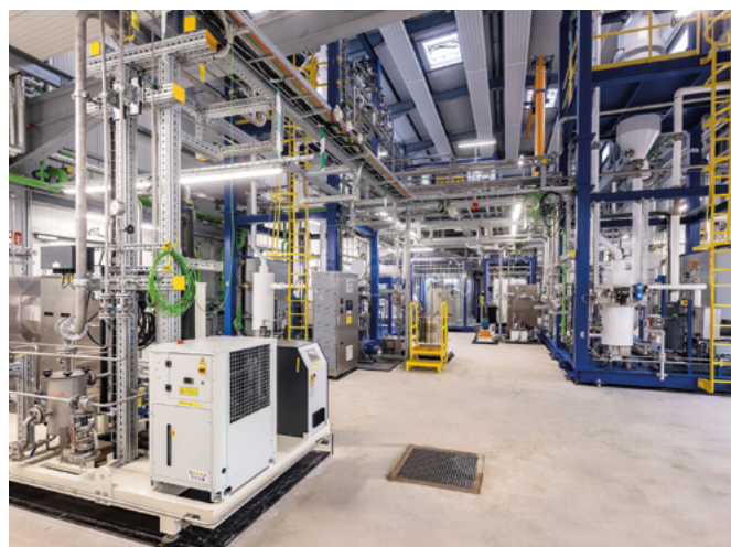
Vulcan Energy 的中央锂电解优化工厂 (CLEOP) (供图: Uli Deck, ARTIS-Photographie)
